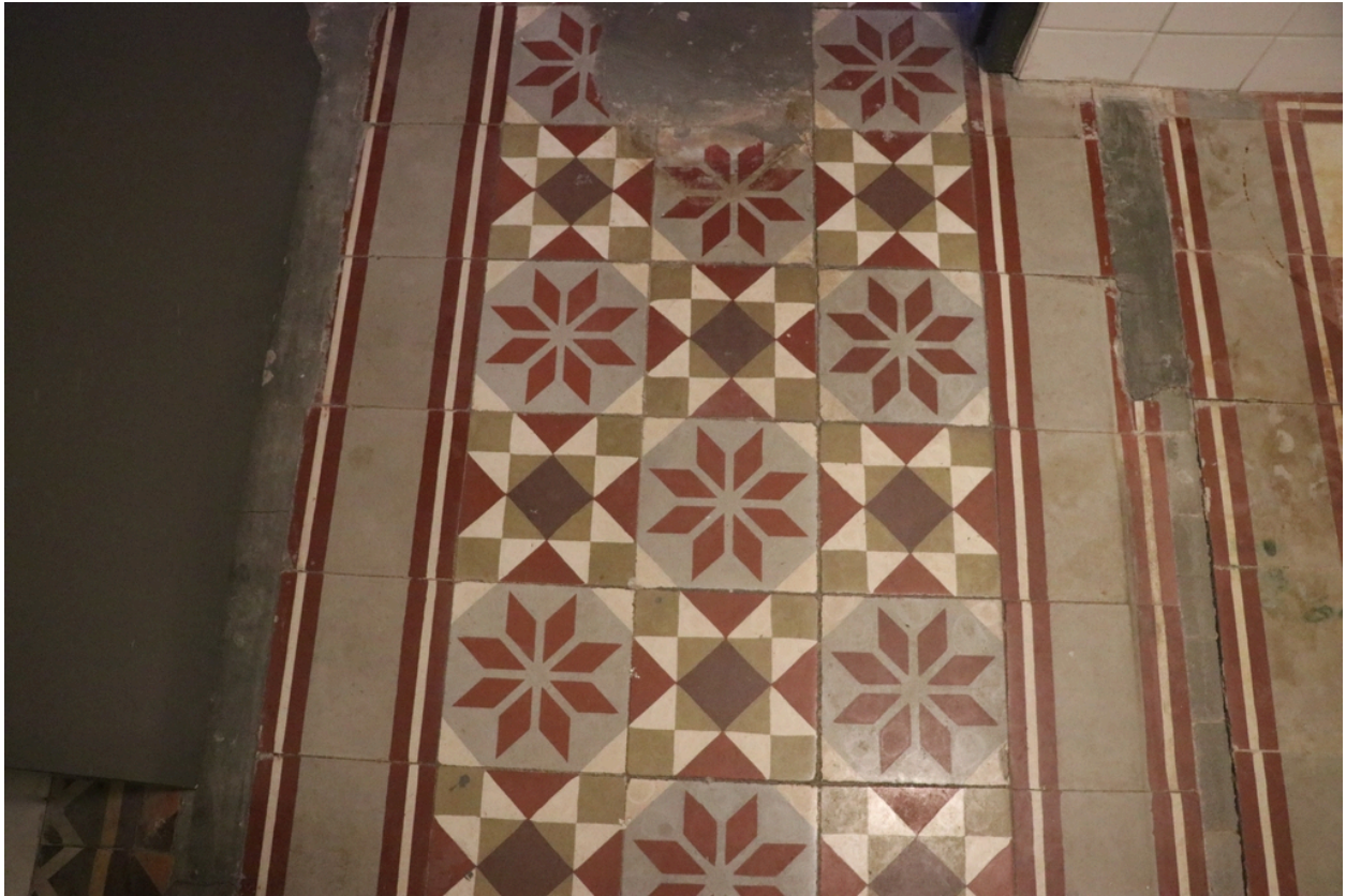
Château Valroch puis Université Catalane d'Été, École de Musique du Conflent et Centre d'accueil Pau Casals - Démarcation de l'ancien couloir de distribution des pièces du rez-de-chaussée de la conciergerie.
