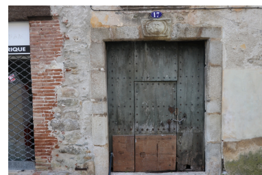
Maison Felip - Porte d'entrée à guichet, façade principale. Phot. Léonie Deshayes IVR76_20216661794NUCA
