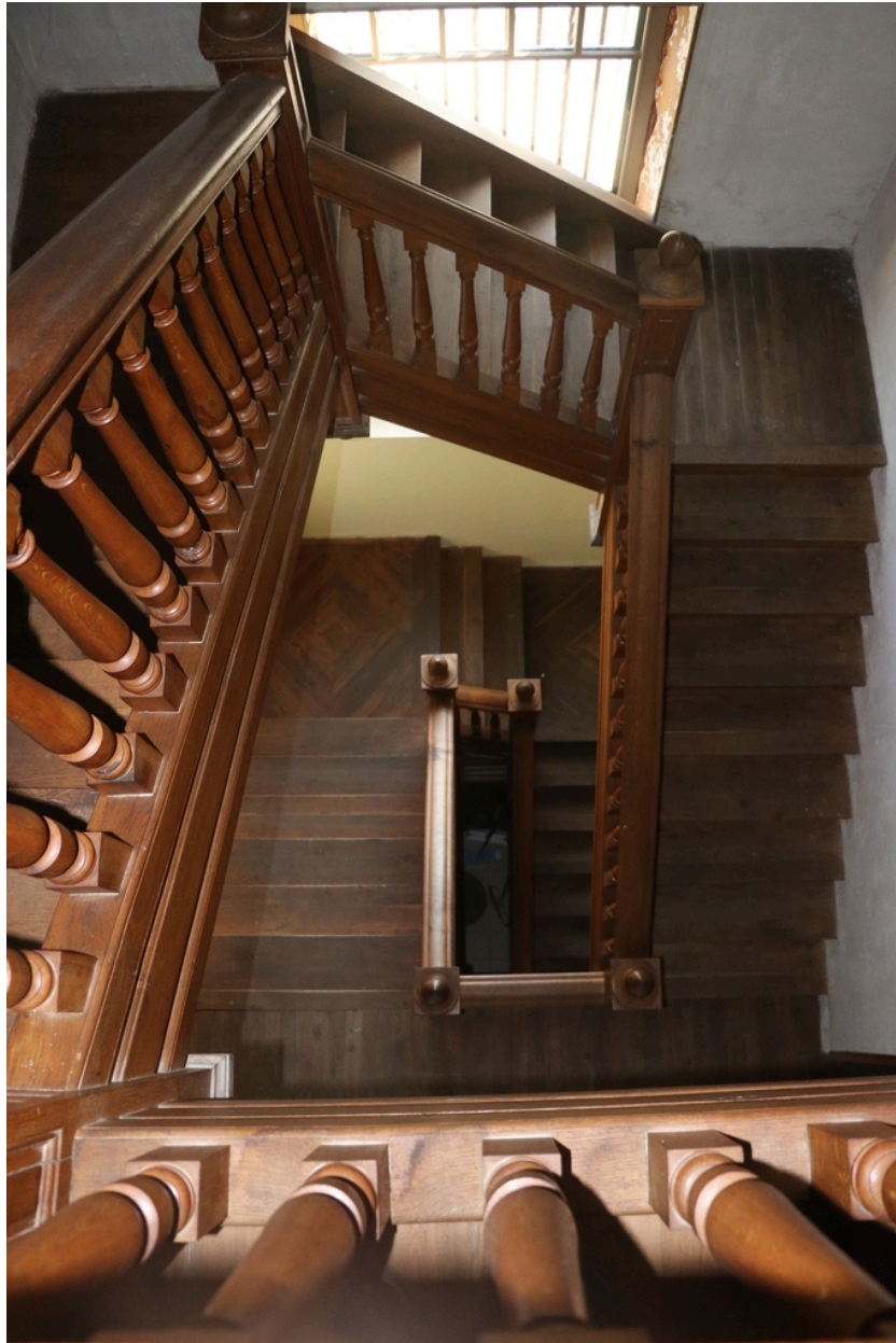
Château Valroch puis Université Catalane d'Été, École de Musique du Conflent et Centre d'accueil Pau Casals - Escalier à volées droites du château.
