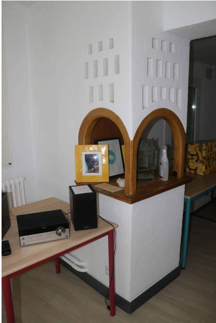
Ancienne maison de Lacroix puis pensionnat Saint-Joseph puis École catalane La Bressola puis médiathèque intercommunale - Niche de la chapelle du pensionnat.
