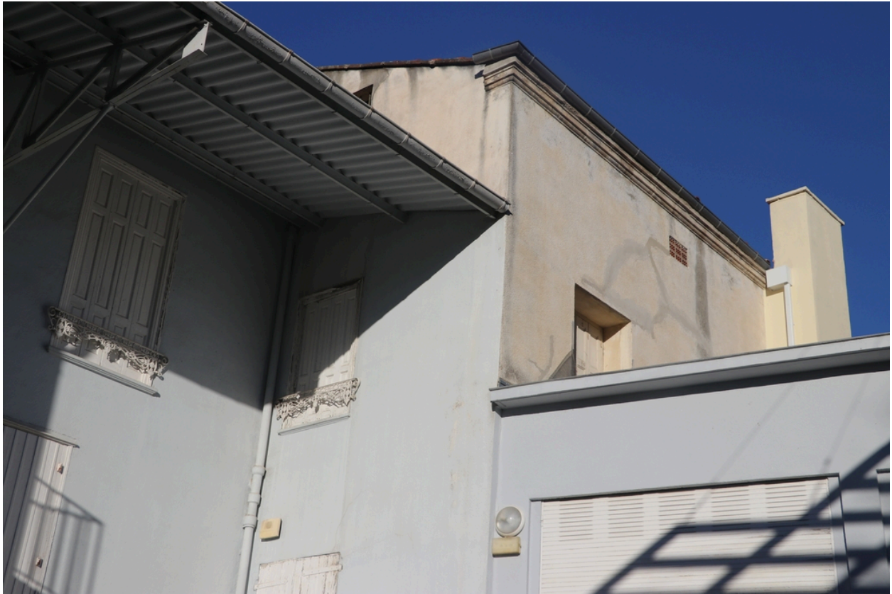
Ancienne maison de Lacroix puis pensionnat Saint-Joseph puis École catalane La Bressola puis médiathèque intercommunale - Corniche moulurée de la maison de Lacroix.
