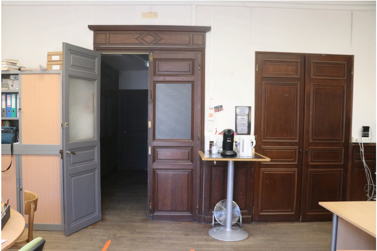
Ancienne maison de Lacroix puis pensionnat Saint-Joseph puis École catalane La Bressola puis médiathèque intercommunale - Porte d'accès au petit salon de la maison de Lacroix.
