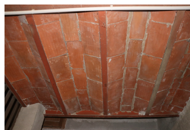
Château Valroch puis Université Catalane d'Été, École de Musique du Conflent et Centre d'accueil Pau Casals - Plancher à solives en fer et vouîtains en briques pleines en sous-sol du château. Phot. Léonie Deshayes IVR76_20226665557NUCA
