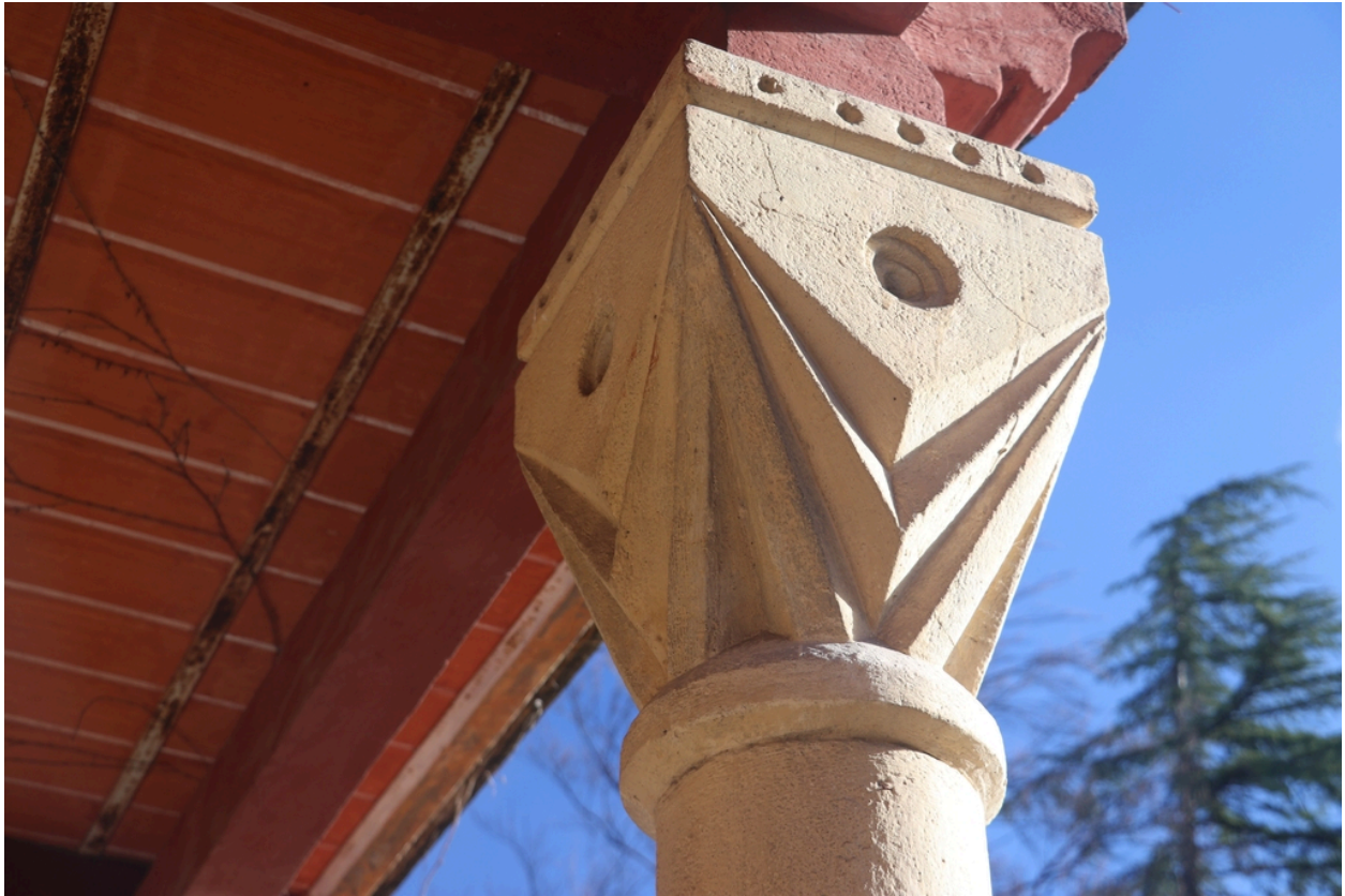
Villa Lafabrègue - Détail d'une colonne de maintien à chapiteau décoratif en béton.
