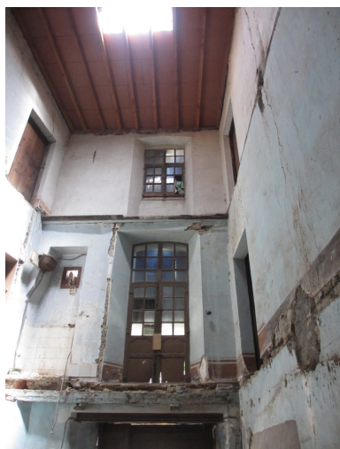
Maison Felip - Élévation intérieure avec puits de jour, 20 Mai 2020. Phot. Filigrane Programmation, Autr. Léonie Deshayes IVR76_20216661804NUCA
