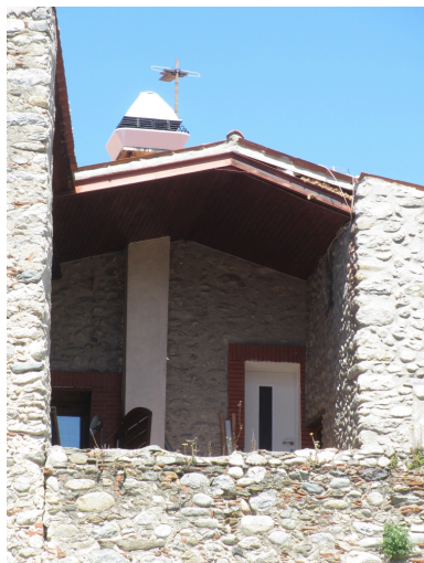
Maison Felip - Porte remaniée localisée au-dessus de l'escalier droit extérieur (façade Ouest), 20 Mai 2020. Phot. Filigrane Programmation, Autr. Léonie Deshayes IVR76_20216661801NUCA
