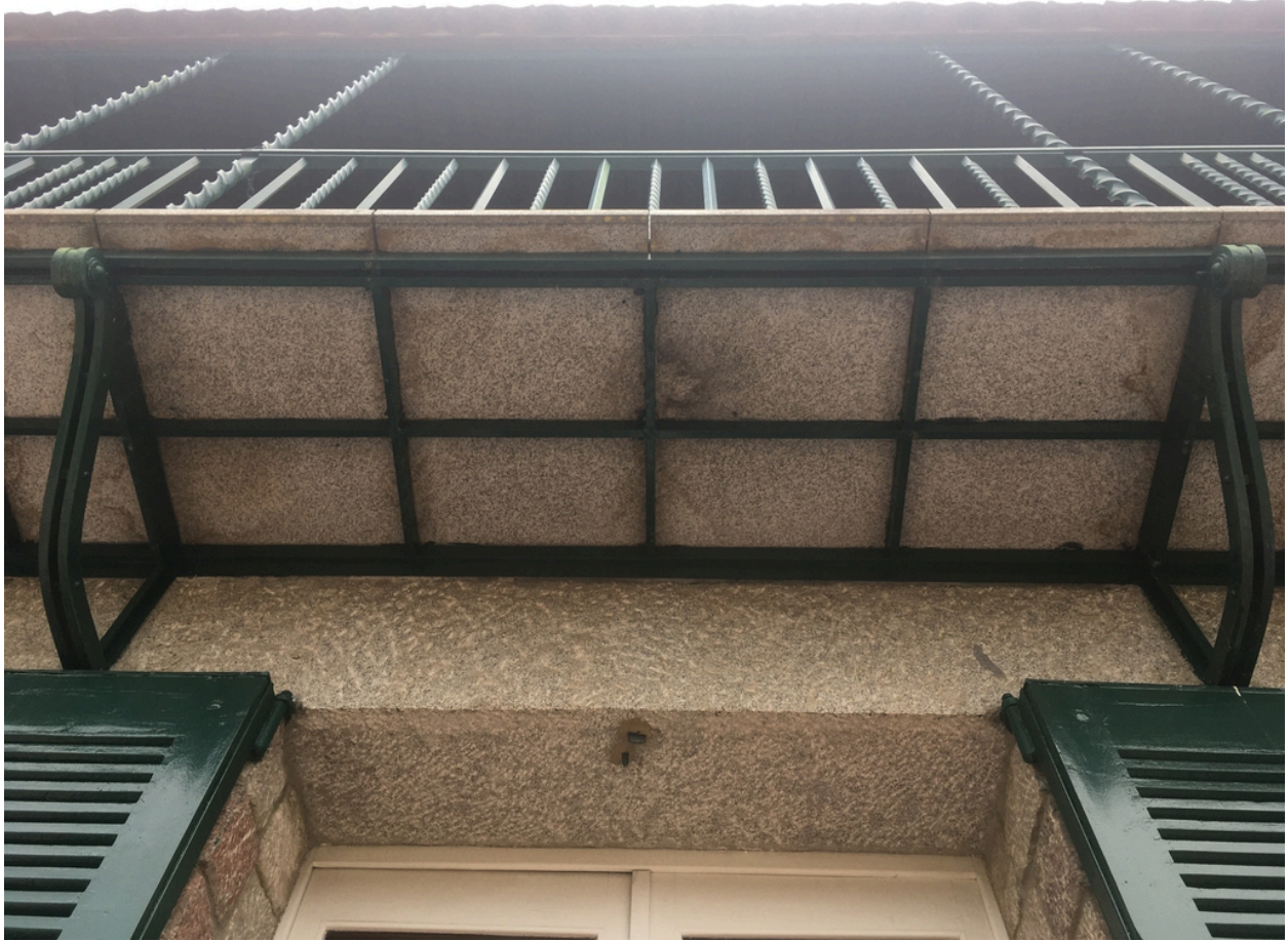
Maison Martin puis Château Las Closas puis Castell Rose - Détail du garde-corps Sud avec dalles de granit.
