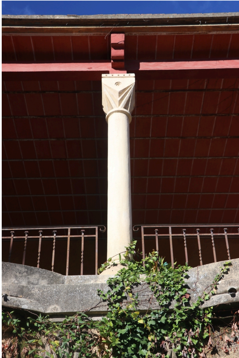
Villa Lafabrègue - Colonne de maintien en béton de la pergola.
