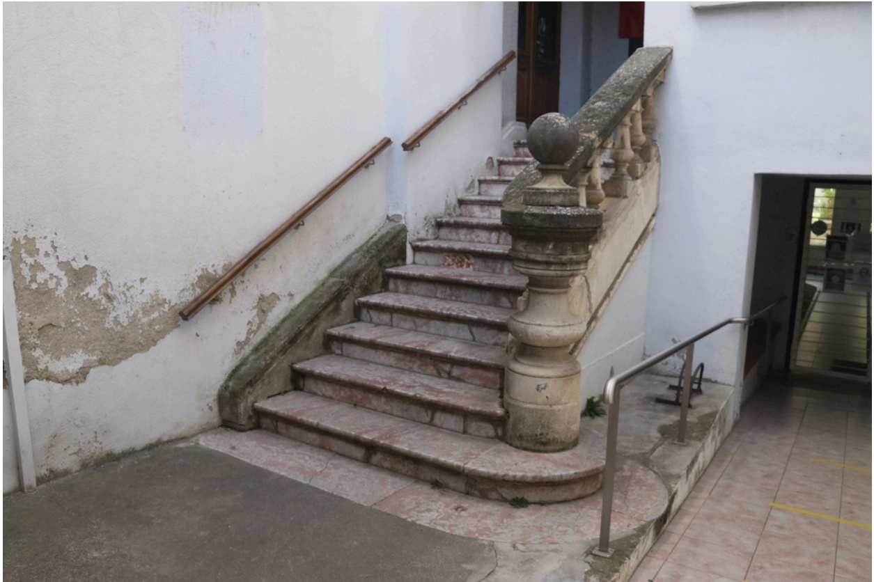
Ancienne maison de Lacroix puis pensionnat Saint-Joseph puis École catalane La Bressola puis médiathèque intercommunale - Escalier d'accès Ouest au premier étage de la maison de Lacroix.
