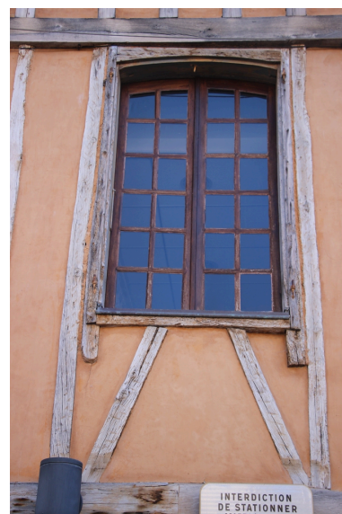
Maison Jourda (maison Jacomet) - Détail d'une baie vitrée à croisillons et chambranle bois à feuillure au premier étage (façade Est). Phot. Léonie Deshayes
