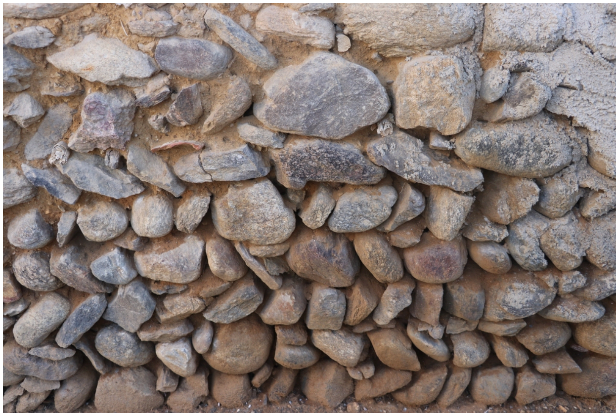
Maison Felip - Maçonnerie disposée en opus spicatum, soubassement de l'habitation cadastrée BE 95 (p).
