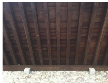
Maison Martin puis Château Las Closas puis Castell Rose - Toit en appentis, à voligeage, chevrons et lambourde muraillère sur corbeaux taillés en granit de la galerie du premier étage, façade Nord. Phot. Léonie Deshayes IVR76_20226665360NUCA
