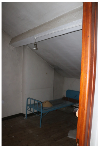
Ancienne maison de Lacroix puis pensionnat Saint-Joseph puis École catalane La Bressola puis médiathèque intercommunale - Chambre à l'étage des combles de la maison de Lacroix. Phot. Léonie Deshayes IVR76_20226665621NUCA
