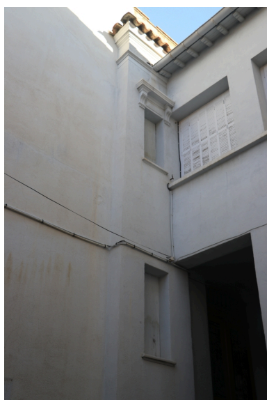
Ancienne maison de Lacroix puis pensionnat Saint-Joseph puis École catalane La Bressola puis
