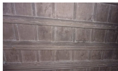
Maison Felip - Plafond à la française dans une pièce donnant sur le jardin au rez de chaussée, 2011, p.20. Phot. Mimi TJOYAS, Autr. Léonie Deshayes IVR76_20216661806NUCA
