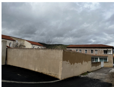
École maternelle, Écoles primaires de filles et de garçons, actuelles école maternelle Pasteur, écoles élémentaires Jean Petit et Jean Clerc - Vue Sud-Est de la cour intérieure et du bâtiment à maçonnerie en marbre rose de l'école élémentaire Jean Clerc. Phot. Léonie Deshayes IVR76_20226665783NUCA
