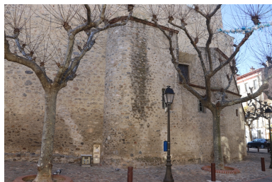
Église paroissiale Saint-Pierre - Tour de fortification arasée à l'angle Nord-Est. Phot. Léonie Deshayes IVR76_20226665487NUCA
