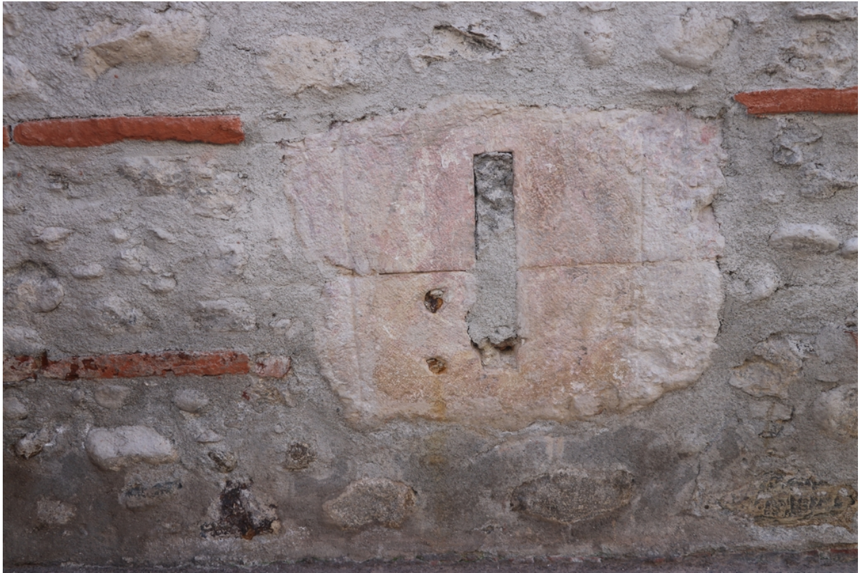
Prison puis Espace Martin Vivès - Détail de blocs de marbre rose avec agrafe recouverte par du ciment en soubassement Est.
