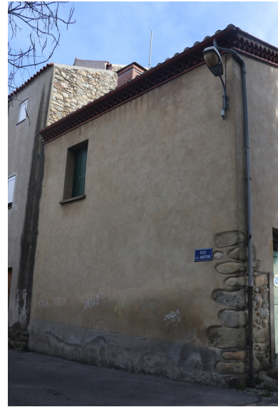
Église Saint-Côme et Saint-Damien puis maisons d'habitation - Façade Nord de l'habitation n°53 bis rue du Pérou. Phot. Léonie Deshayes IVR76_20226665537NUCA
