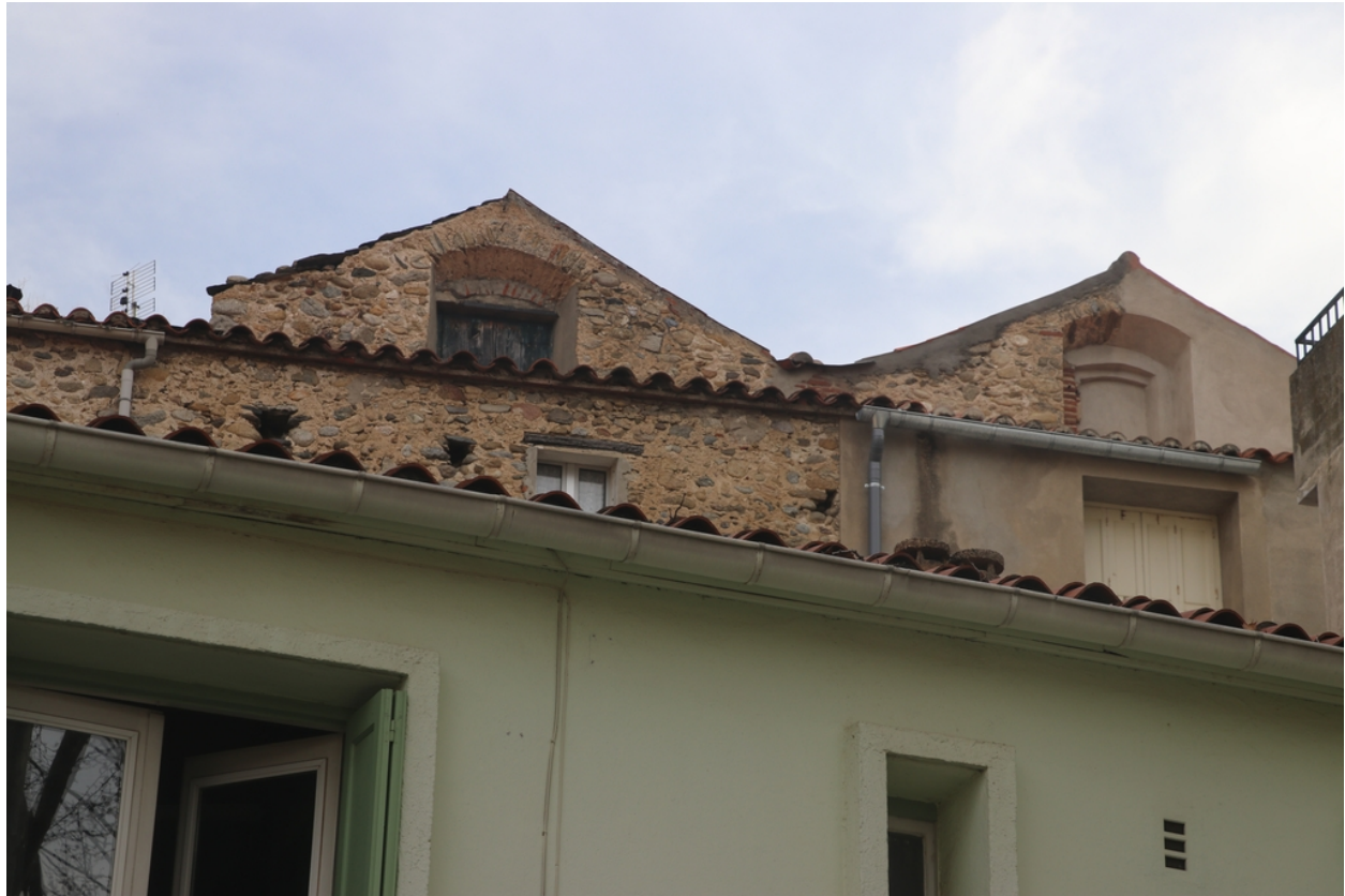
Église Saint-Côme et Saint-Damien puis maisons d'habitation - Vue Nord des fenêtres hautes de la nef remaniées.
