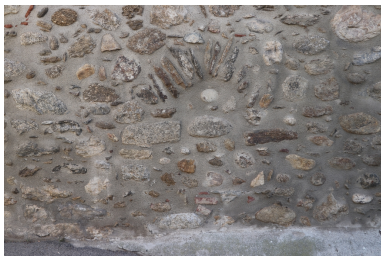
Église Saint-Côme et Saint-Damien puis maisons d'habitation - Ouverture bouchée en soubassement Est de l'habitation n°61 rue du Pérou. Phot. Léonie Deshayes IVR76_20226665532NUCA
