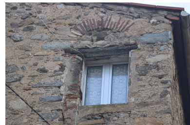
Église Saint-Côme et Saint-Damien puis maisons d'habitation - Baie remaniée avec encadrement d'origine en façade Est de l'habitation n°59 rue du Pérou. Phot. Léonie Deshayes IVR76_20226665534NUCA
