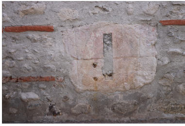
Prison puis Espace Martin Vivès - Détail de blocs de marbre rose avec agrafe recouverte par du ciment en soubassement Est. Phot. Léonie Deshayes IVR76_20226665762NUCA
