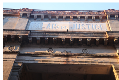
Palais de justice-Tribunal - Détail de l'entablement supérieur en façade sur rue. Phot. Léonie Deshayes IVR76_20226665727NUCA
