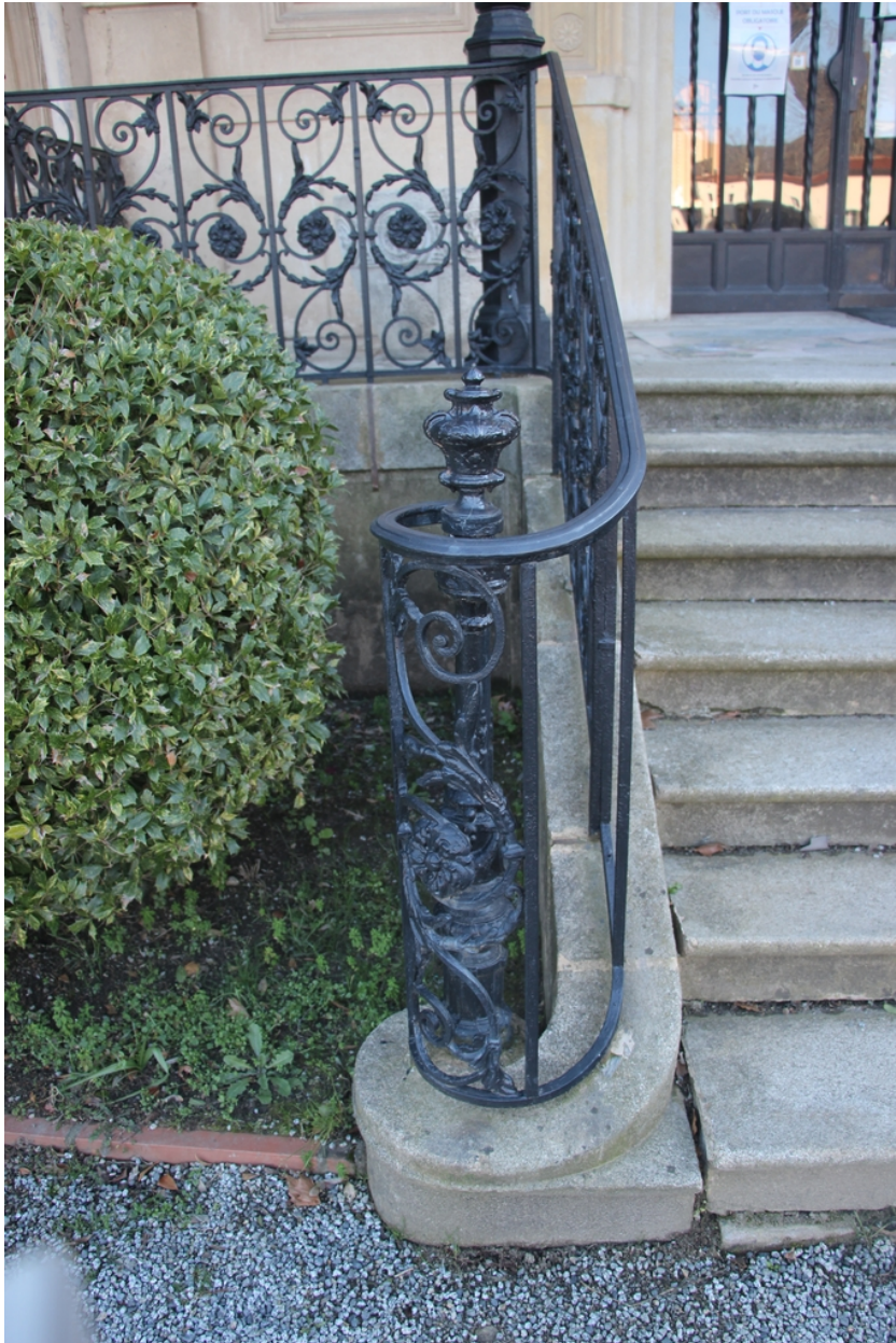
Château Pams puis Hôtel de ville - Détail de l'escalier extérieur Nord à première marche et rampe en fer forgé.
