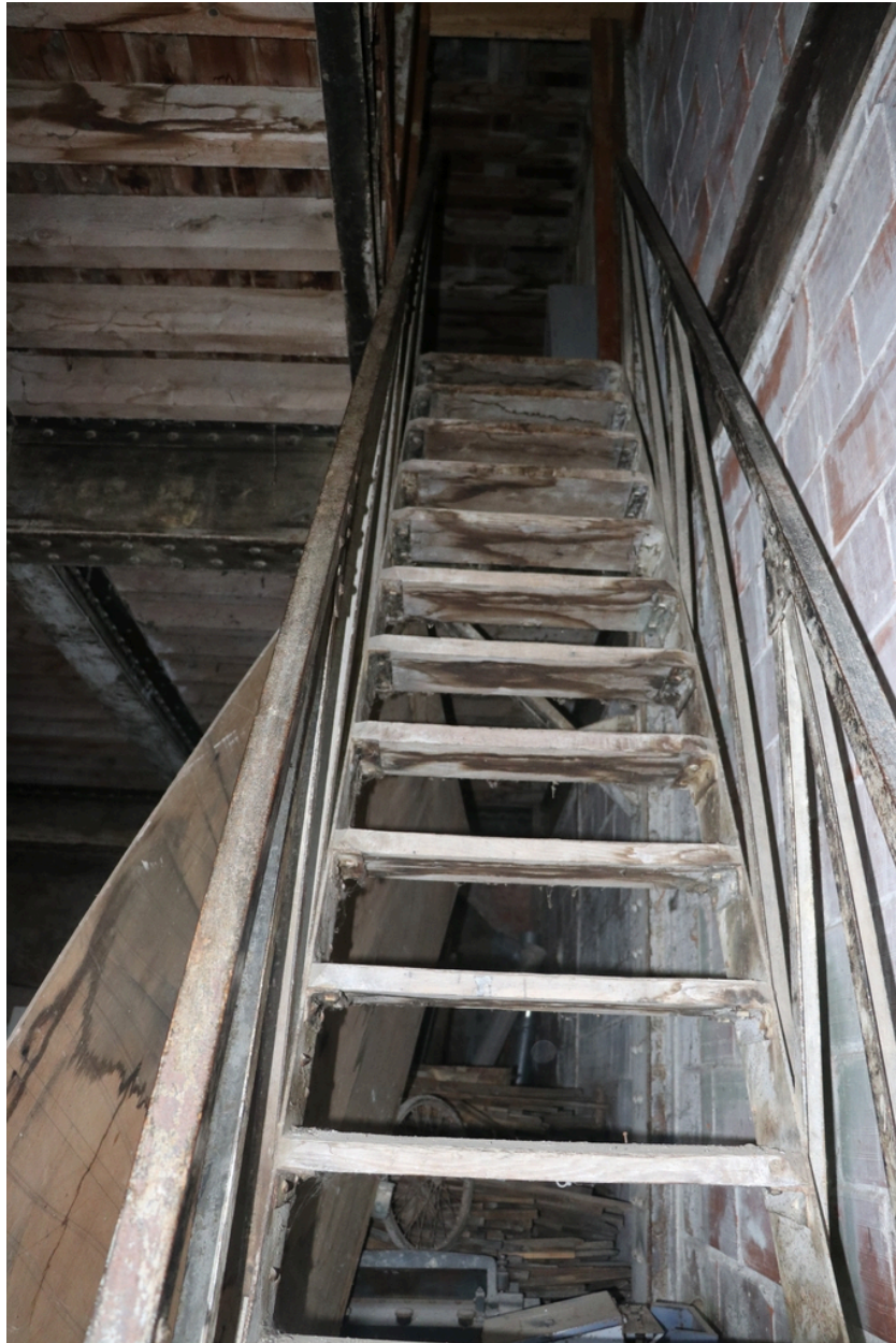
Site industriel de Gibraltar - Escalier de liaison entre le rez-de-chaussée et le premier étage d'un bâtiment industriel de l'usine Chefdebien.
