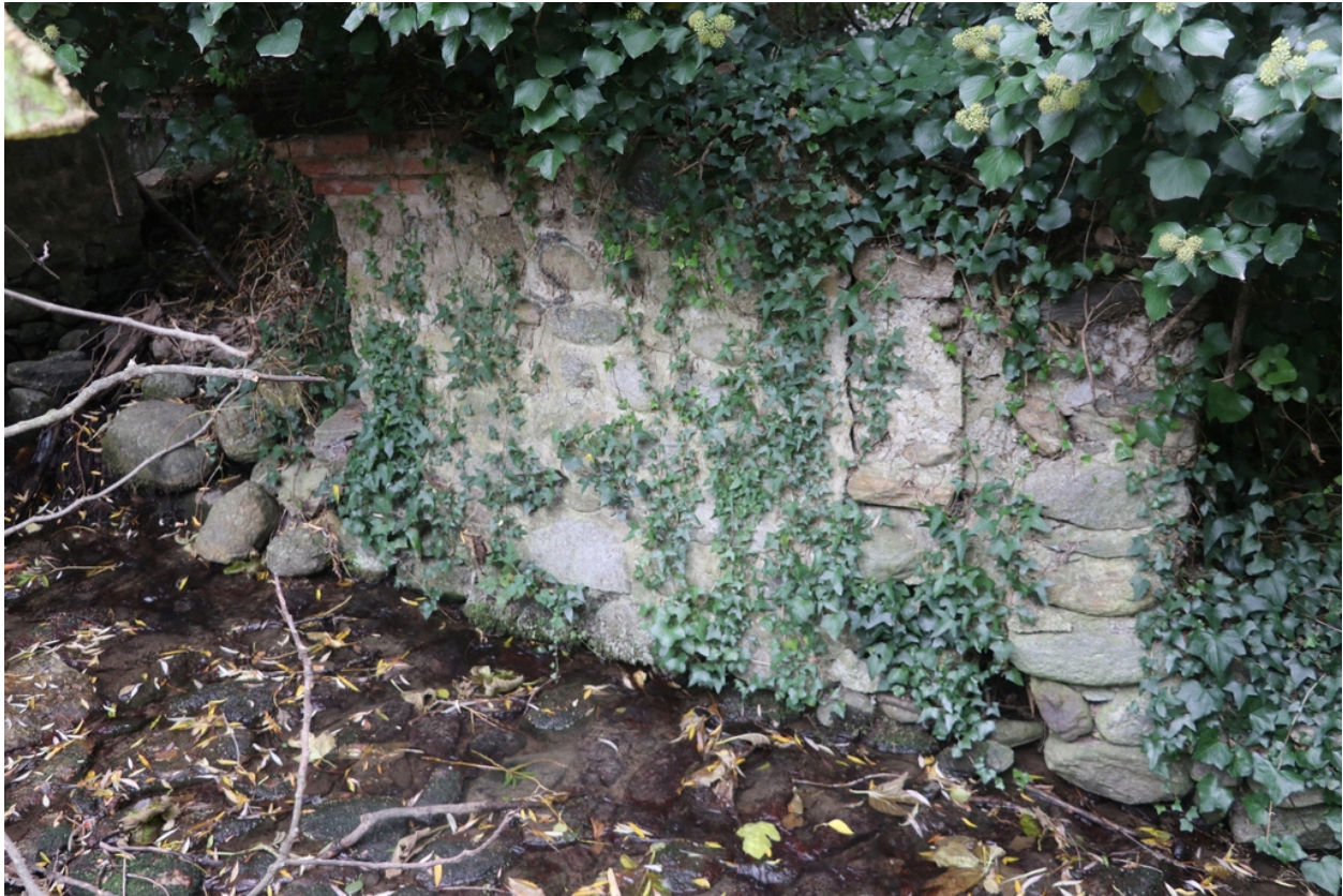
Moulin à farine Neuf puis Bès - Vestiges d'un soubassement de mur au niveau du canal d'amenée.
