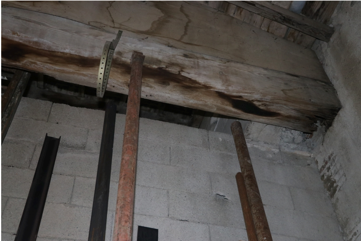
Site industriel de Gibraltar - Poutre de charpente en mauvais état, second niveau d'un bâtiment industriel de l'usine Chefdebien.
