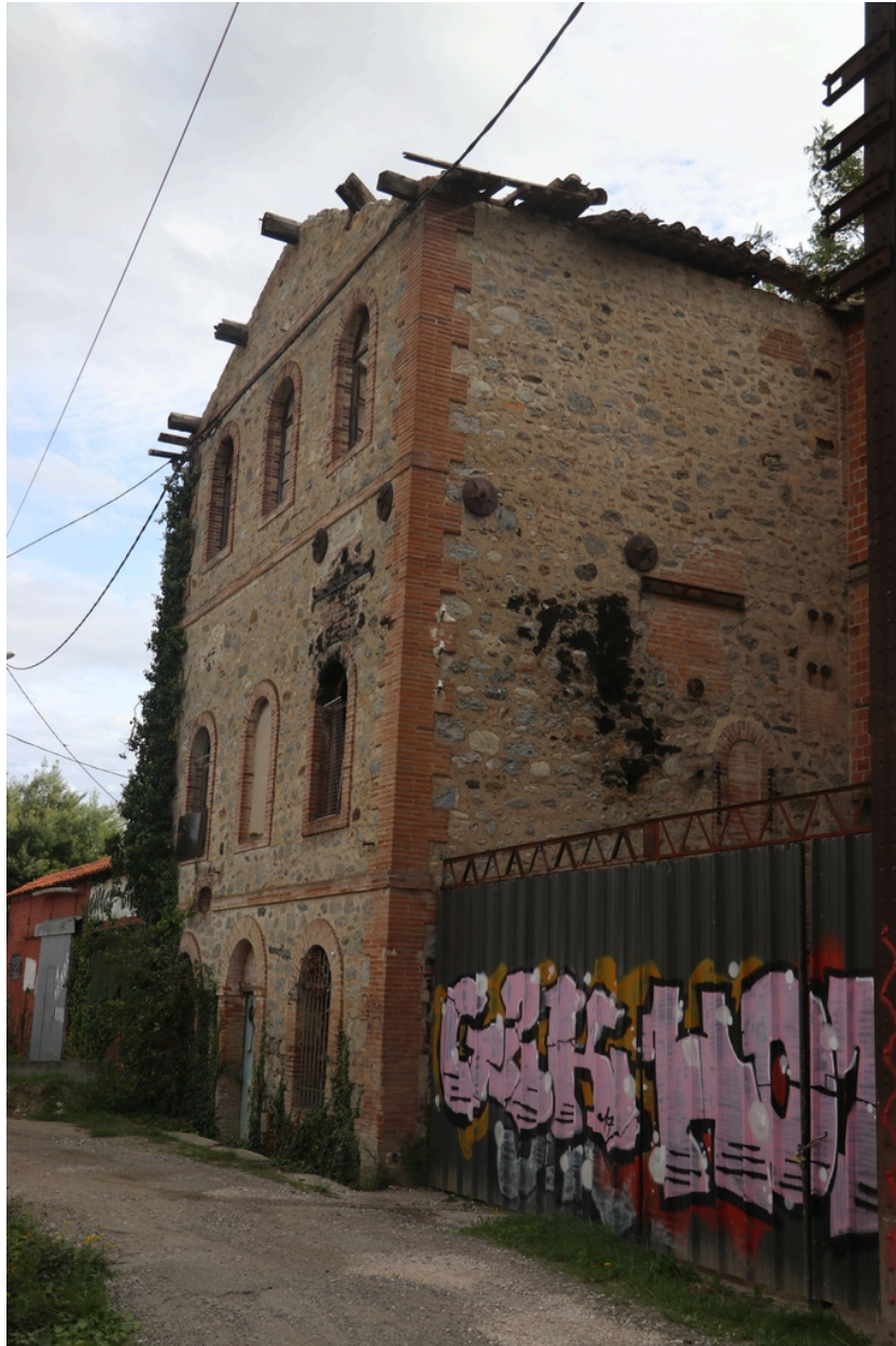
Site industriel de Gibraltar - Bâtiment industriel de l'usine chefdebien avec toiture en mauvais état.
