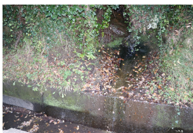
Canal de Dalt - Alimentation de la Branche ancienne par une eau de source. Phot. Léonie Deshayes IVR76_20216661978NUCA
