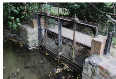
Moulin à farine Neuf puis Bès - Vanne de décharge vers le canal d'amenée du moulin. Phot. Léonie Deshayes IVR76_20216665120NUCA
