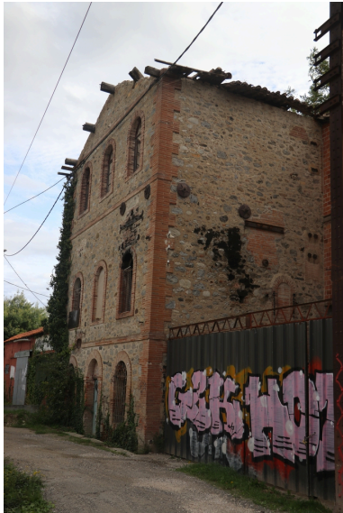
Site industriel de Gibraltar - Bâtiment industriel de l'usine chefdebien avec toiture en mauvais état. Phot. Léonie Deshayes IVR76_20216665154NUCA
