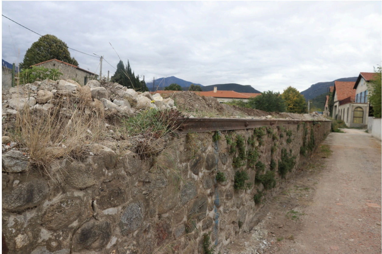
Site industriel de Gibraltar - Mur de soutènement du quai de chargement utilisé par l'ancienne usine Chefdebien.
