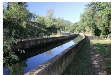
Canal Union - Tronçon développé en bordure de la Route nationale 116. Phot. Léonie Deshayes IVR76_20216665002NUCA
