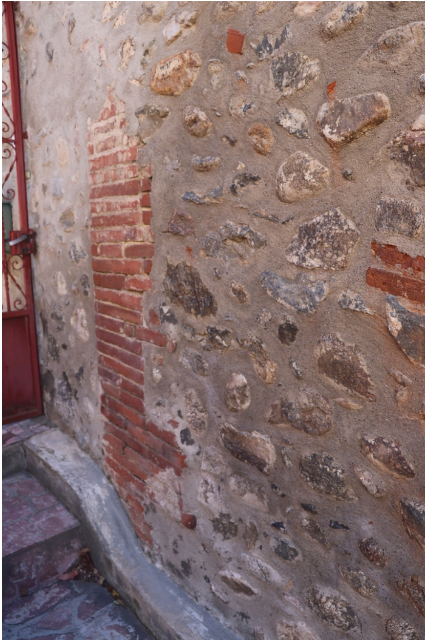
Moulin à farine communal - Piédroit en cayrou conservé de l'accès Est colmaté postérieurement.
