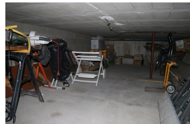
Moulin à farine communal - Sous- sol transformé en cave/débaras. Phot. Léonie Deshayes IVR76_20216665036NUCA
