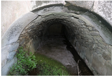
Moulin à farine communal - Chambre hydraulique avec maçonnerie apparente. Phot. Léonie Deshayes IVR76_20216665031NUCA
