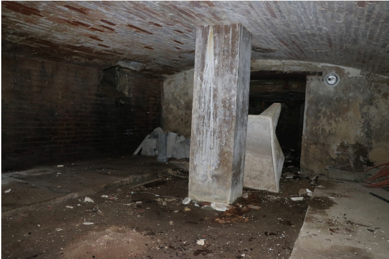
Ancien moulin à huile du sieur Tixedor, puis chocolaterie, puis usine électrique - Espace de production du chocolat en sous-sol.
