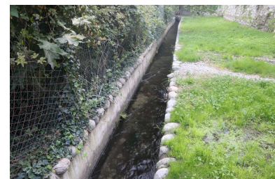
Canal Rec de Baix - Tronçon en bordure des sources dites du Cami Nou. Phot. Léonie Deshayes IVR76_20216665009NUCA
