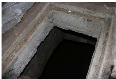
Moulin à farine Neuf puis Bès - Intérieur de la cave avec trappe d'accès à la chambre hydraulique. Phot. Léonie Deshayes IVR76_20216665116NUCA
