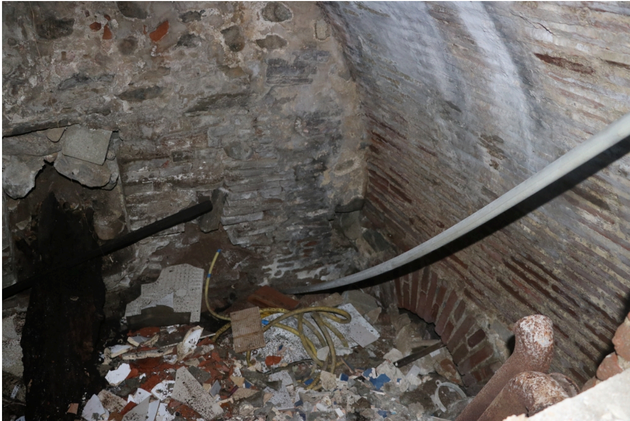
Ancien moulin à huile du sieur Tixedor, puis chocolaterie, puis usine électrique - Axe horizontal et barre de transmission conservés dans la chambre hydraulique du moulin à huile 1).
