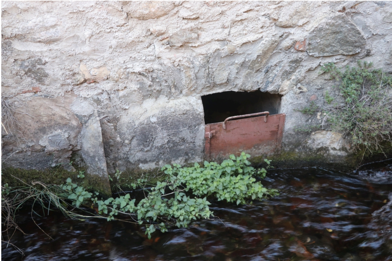
Ancien moulin à huile du sieur Tixedor, puis chocolaterie, puis usine électrique - Ouverture à vanne en fer en soubassement du moulin à huile.
