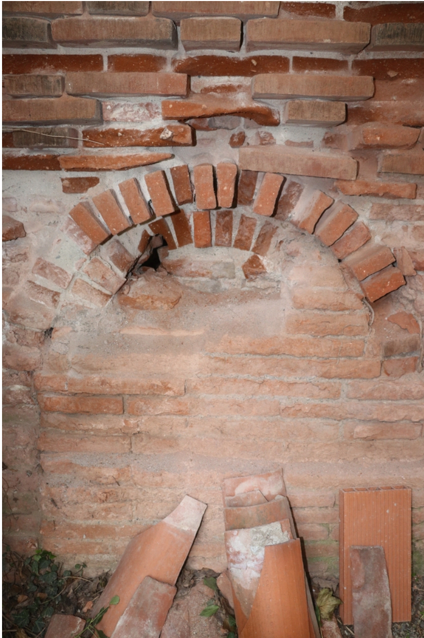
Site industriel de Gibraltar - Entrée Ouest colmatée de la cheminée.
