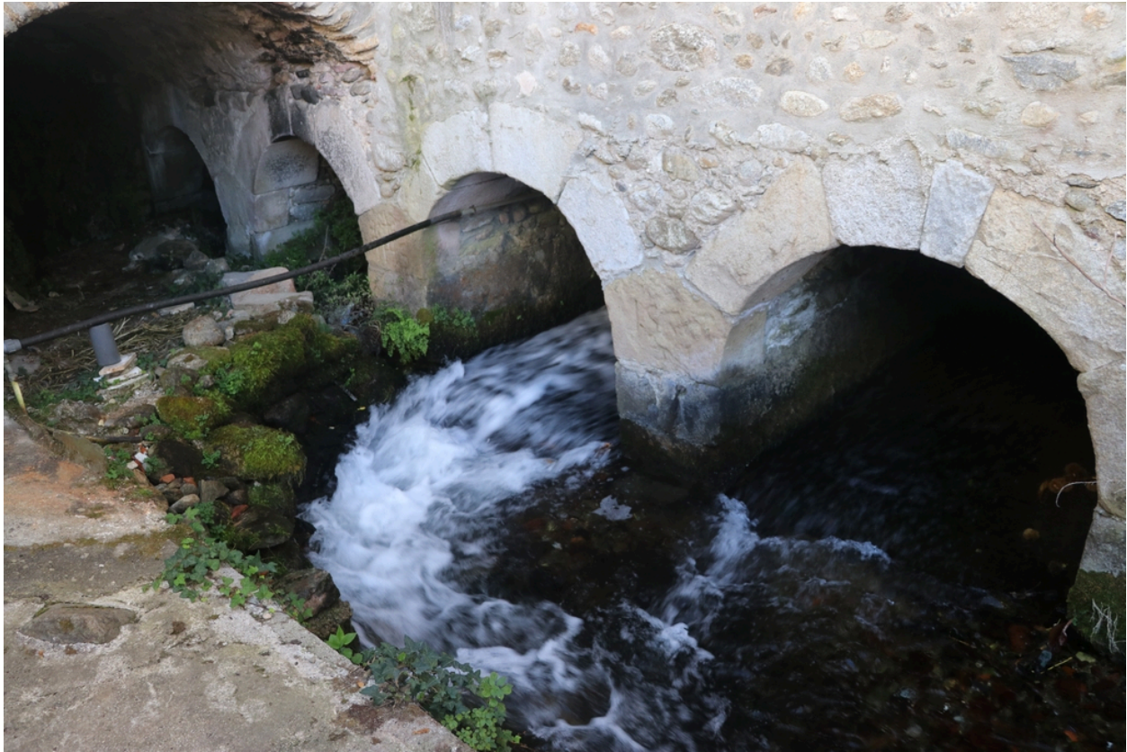
Moulin à farine communal - Passage du canal de fuite sous les arches voûtées.
