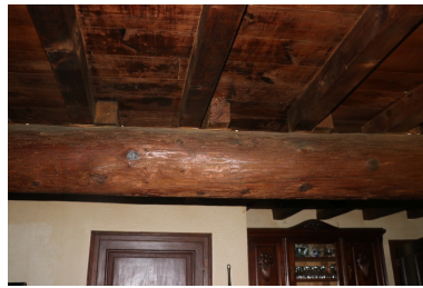
Moulin à farine Neuf puis Bès - Plancher avec poutre massive, solives et planches en bois au premier étage. Phot. Léonie Deshayes IVR76_20216665128NUCA
