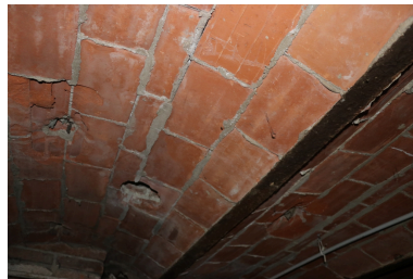
Usine Illes - Plancher à solives en fer et voûtains en briques pleines en sous-sol. Phot. Léonie Deshayes IVR76_20216665092NUCA
