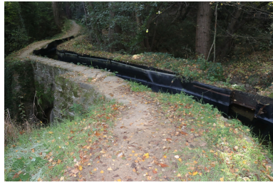
Canal de Bohère - Décharge dite de la Basse. Phot. Léonie Deshayes IVR76_20216661932NUCA
