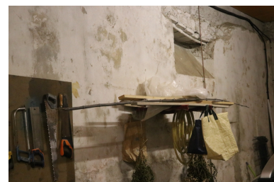
Ancien martinet à cuivre du sieur Comte et actuelle habitation n°5 bis rue Saint-Martin - ouverture inclinée en sous-sol. Phot. Léonie Deshayes IVR76_20216665018NUCA
