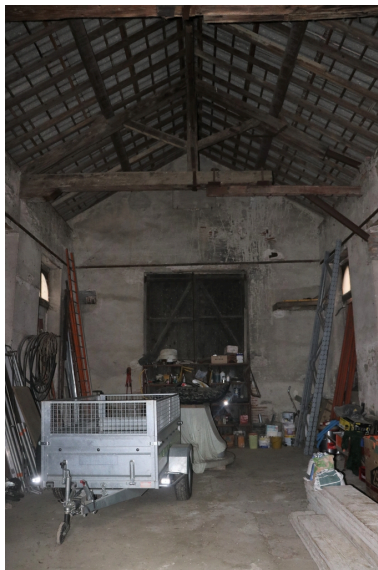
Site industriel de Gibraltar - Intérieur du bâtiment à chaudière et turbines. Phot. Léonie Deshayes IVR76_20216665140NUCA
