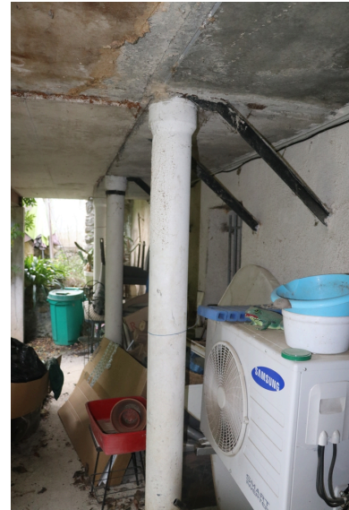
Usine Illes - Rez-de-chaussée Est avec pieds de force en fer forgé. Phot. Léonie Deshayes IVR76_20216665090NUCA
