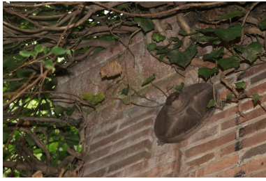
Site industriel de Gibraltar - Détail d'une croix de chaînage sur la cheminée. Phot. Léonie Deshayes IVR76_20216665145NUCA
