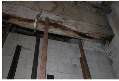
Site industriel de Gibraltar - Poutre de charpente en mauvais état, second niveau d'un bâtiment industriel de l'usine Chefdebien. Phot. Léonie Deshayes IVR76_20216665161NUCA
