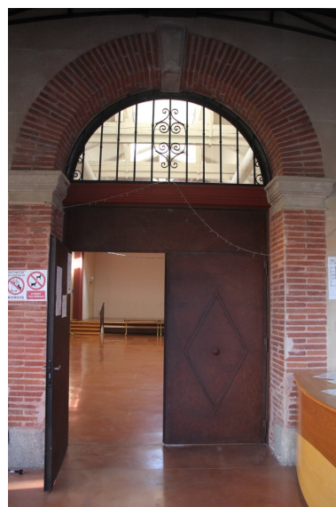
Abattoir puis Salle du Foirail - Portail d'entrée principal. Phot. Léonie Deshayes IVR76_20226665428NUCA
