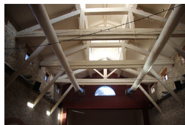
Abattoir puis Salle du Foirail - Charpente en bois apparente. Phot. Léonie Deshayes IVR76_20226665431NUCA
