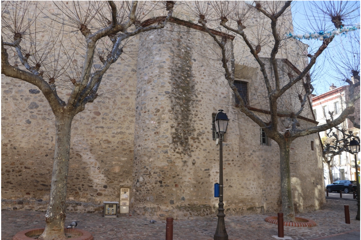
Vestige d'une tour arasée de la cellera à l'angle Nord-Est de l'église paroissiale Saint-Pierre.
