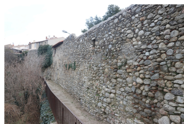
Détail de la maçonnerie du second rang de fortifications Nord. Phot. Léonie Deshayes IVR76_20226665666NUCA
